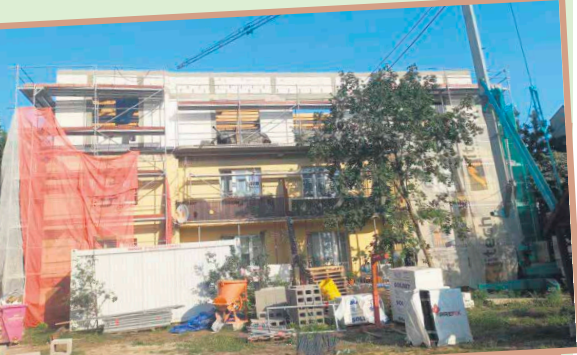
Trwają prace budowlane i wkrótce Miasto Zielonka wzbogaci się o cztery nowe mieszkania komunalne
